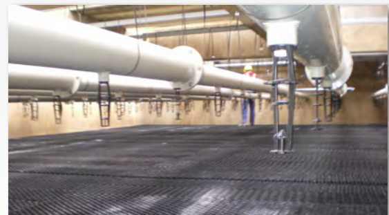
Wasserverteilung aus PVC oder PP-Rohr, GfK oder Holzrinnen
