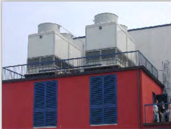
Einsatzbeispiel: offene Kühltürme
